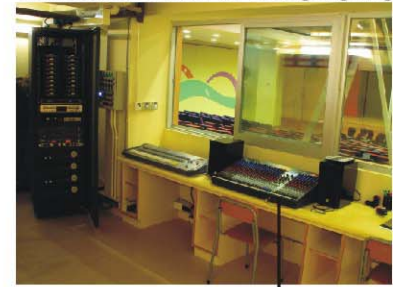
Main control room for AV & stage lighting
