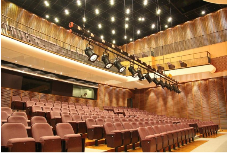
部份原有的舞台燈掛在台前的新電動燈杆上，為舞台現場提供局部光源。
