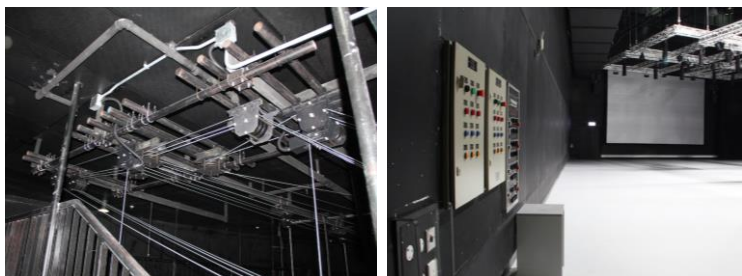
電動桁架系統共有 8 組鋁合金桁架，劇場內備有控制台，進行精確和安全的提升及下降操作。
