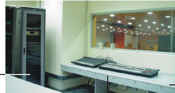
Main Control Room for AV & Stage lighting
